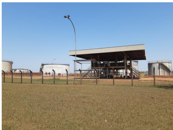
Figura 5: Tanques de armazenamento para distribuição.
