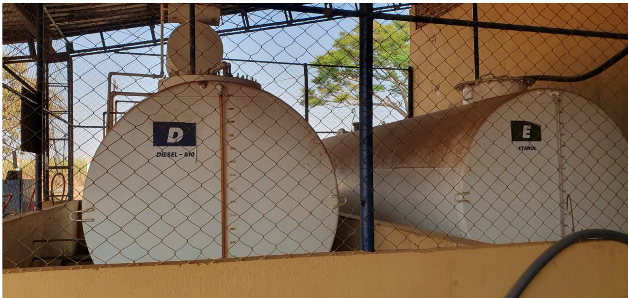
Foto 2: Posto de combustíveis da Usina Lasa Lago Azul.
